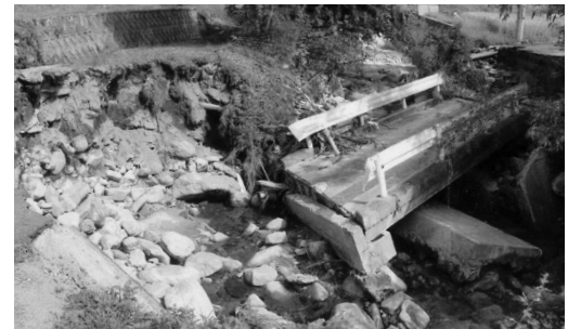
河川護岸(伏谷川)の崩壊による落橋現場 (湯来町大字伏谷 堀田銘木店付近)
