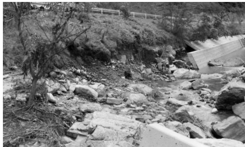
水内川の河川崩壊 (湯来町大字多田 湯来西小学校付近)
